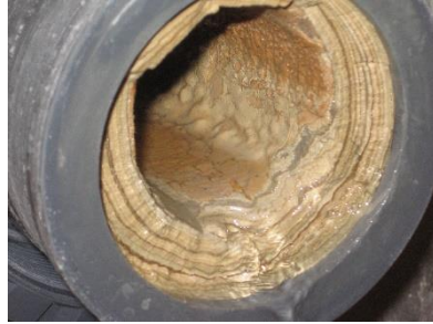
Termákvíz okozta lerakódás
