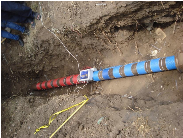
Vízhálózat kezelése MRAZ ® SYSTEM TECHNOLOGY E - 100
