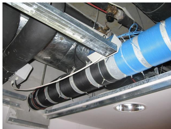
Szálloda vízkezelése MRAZ SYSTEM TECHNOLOGY E - 50
